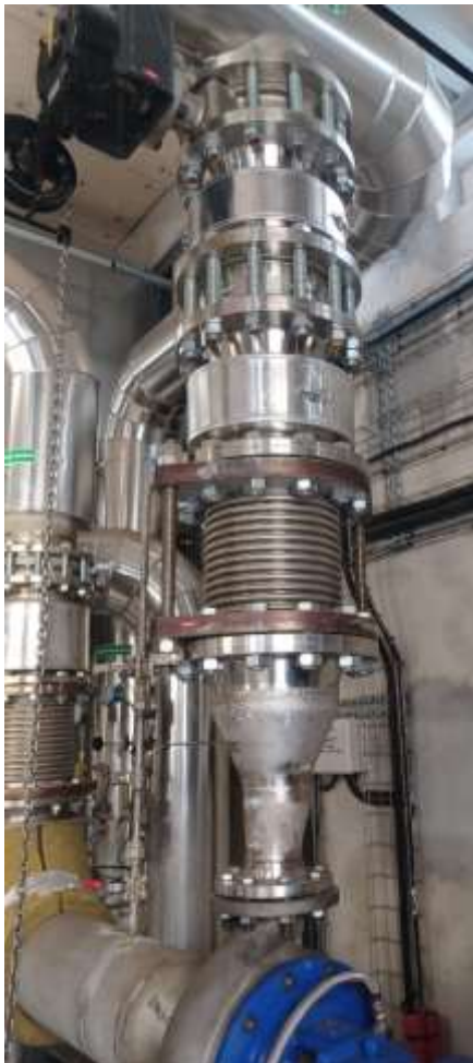
Reprise contrainte tuyauterie de la pompe
