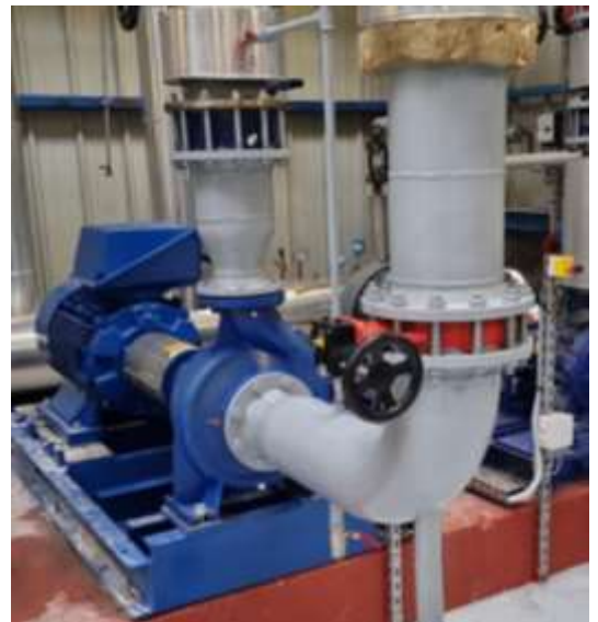
Pompe réseau N°2
