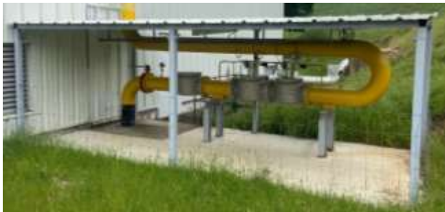
Abri pour les électrovannes gaz de la chaufferie
