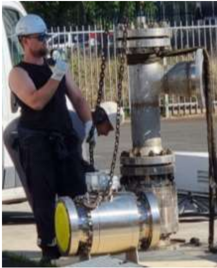
Vanne maitresse tête de puits
