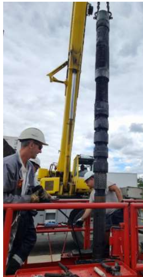
Remontée de la pompe Exhaure
